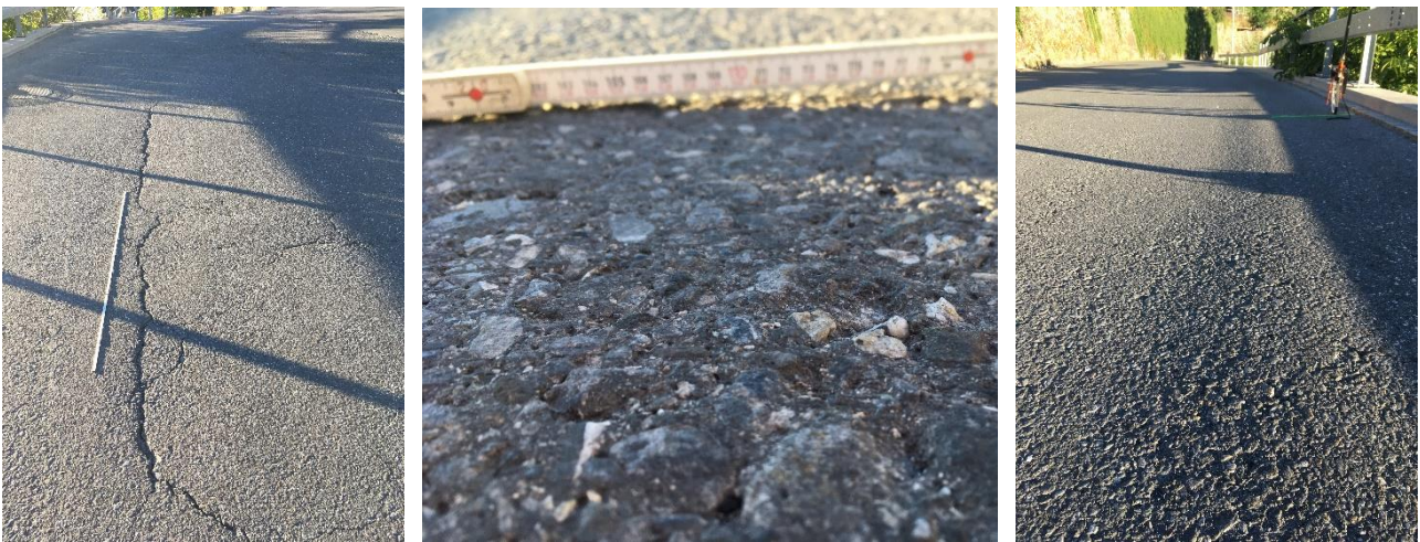
Abbildung 1: Visuelle Erhebung und Bewertung von Oberflächenschäden (Längsriss, Polieren, Senkung)
